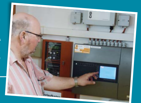
Volker Schröter überprüft die neue Brandmeldeanlage im Altenzentrum St. Johannes in Mayen.
